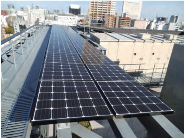
太陽光パネル (名古屋駅前ビル)
