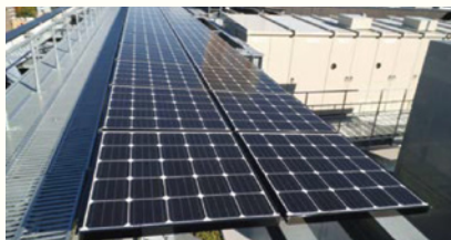
太陽光パネル (名古屋駅前ビル)
