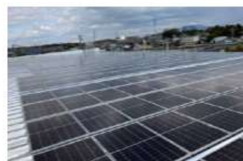
※設置したパネルの実物写真
