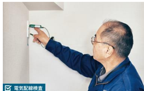
☑ 電気配線検査
