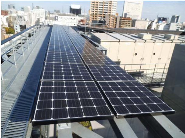
太陽光パネル (名古屋駅前ビル)
